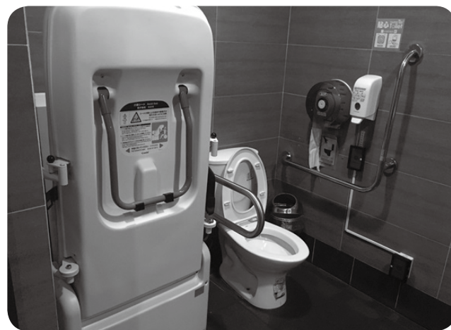
▲無障礙廁所內的照護床（左）。
